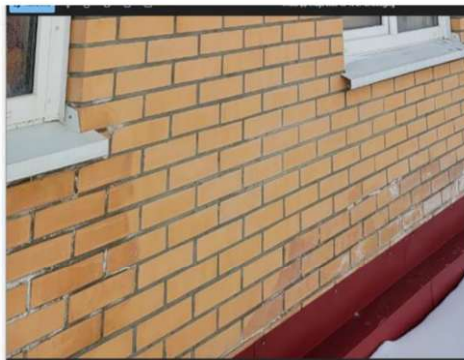
Рисунок 1 – Образование высолов на кирпичной кладке
